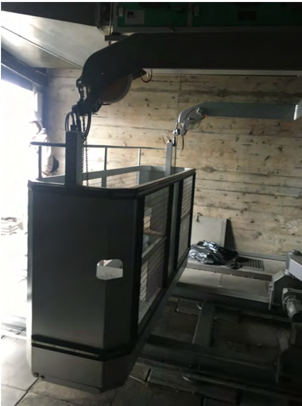
Abb. 11: Fassadenbefahranlage in Garage auf dem Dach
