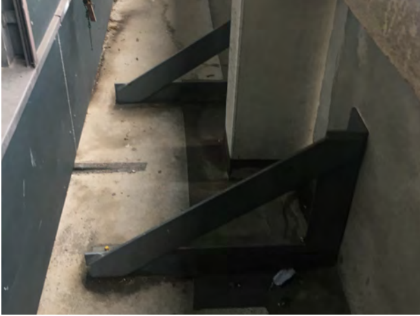
Abb. 9: Nachgerüstete Befestigung der Brüstungselemente
