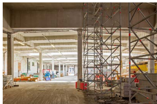
Wohnsiedlung und Tramdepot Depot Hard, Übergang von der neuen zur alten, denkmalgeschützten Tramhalle, die komplett instandgesetzt wird. (Bild: Juliet Haller, Amt für Städtebau)
