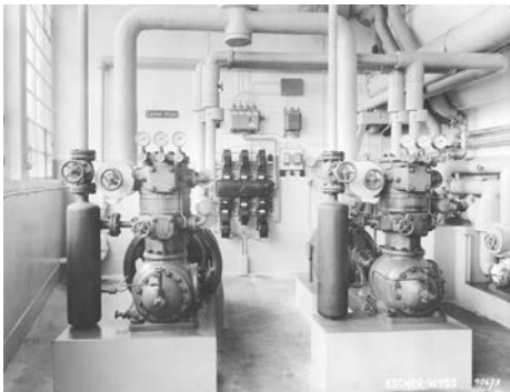
Titel: Maschinenraum mit 2 Kompressoren G 141
